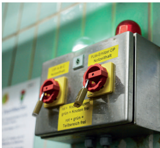
[ Bild 3 Verriegelung/Warnsignal: Mechanische Verriegelung mit optischem Warnsignal (Leuchten Rot/Grün) am Durchgang zum Ventilknoten ]
